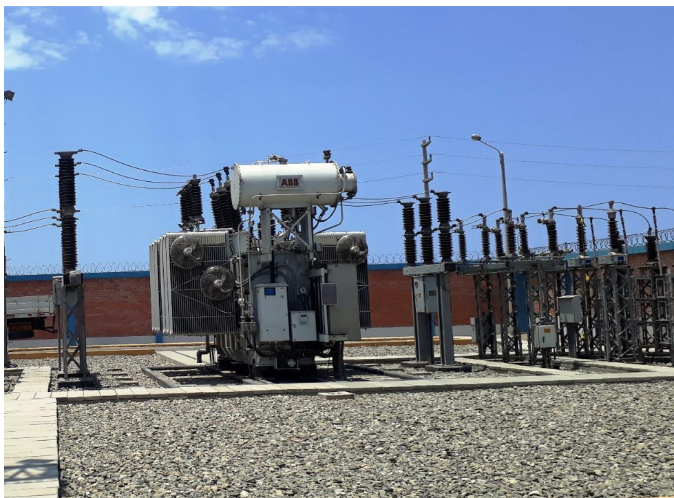
Figura 7. Transformador de la SE HUACA DEL SOL
